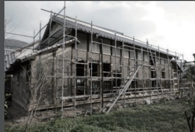
⑤解体後 壁の崩落はあるが柱梁は健全
