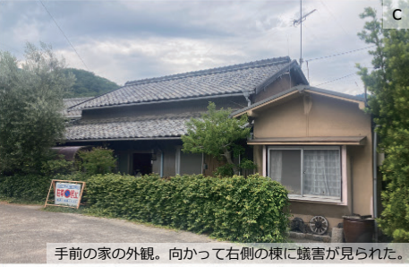
手前の家の外観。向かって右側の棟に蟻害が見られた。
