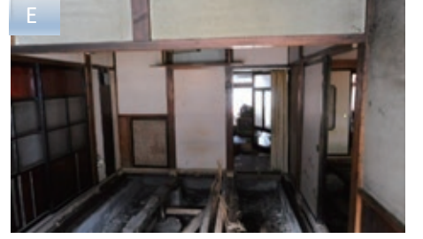
床下浸水で床が落ちた台所(再生前)
