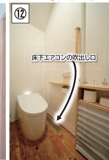
洗面・脱衣室、トイレにも「床下エアコン」の吹き出し口 ヒートショック対策
