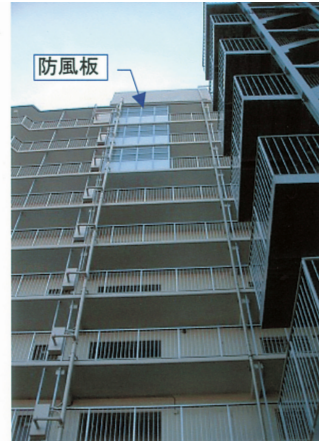
photo-2 : EVホール防風板
