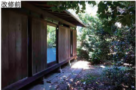
2.しばらく放置されていた空き家。ガラスは割れ、雨戸が閉じられた状態でした。
