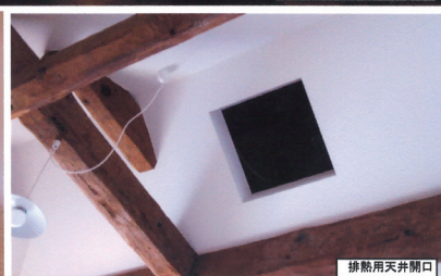
排熱天井開口
